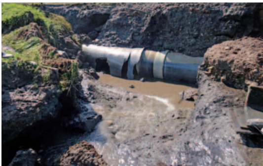
《管の破損状況》
