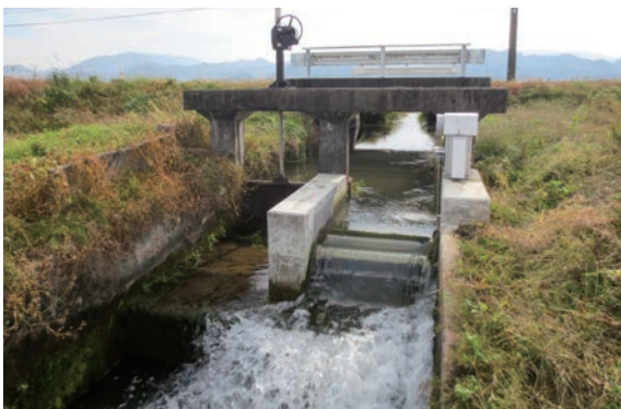
完成後のゲート写真(会津美里町下堀地内)
