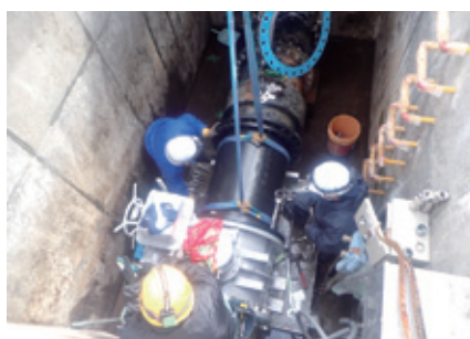
電動バタフライ弁設置状況
